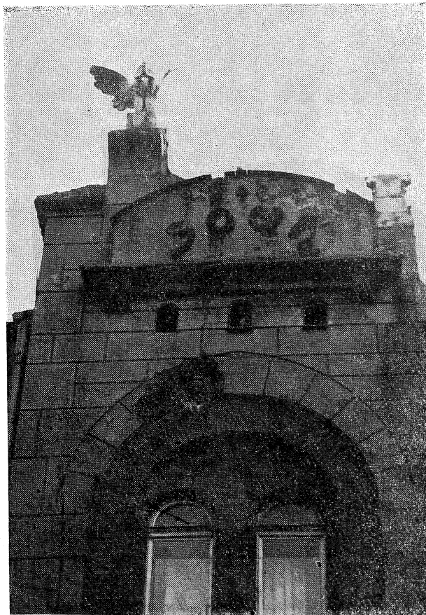
Aleja Krasińskiego 23 Atmosferyczne zniszczenie figury przedstawiającej sowę — godło domu
