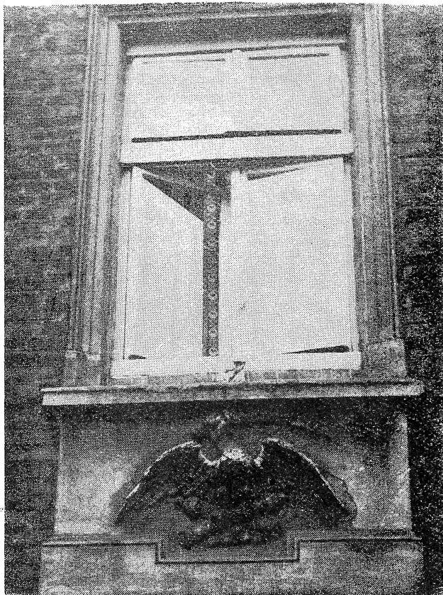
Ulica Kościuszki 34 Mechaniczne uszkodzenie głowy orła (przez utracenie) — gołdo domu
