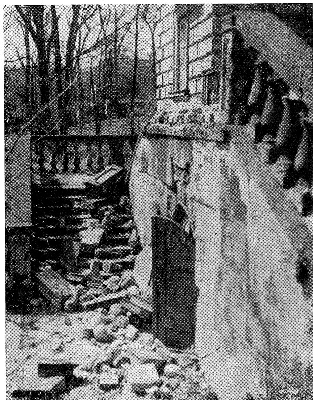
Wola Justowska, Willa Decjusza Mechaniczne zniszczenie (dokonane przez wandalów) renesansowej balustrady kamiennej
