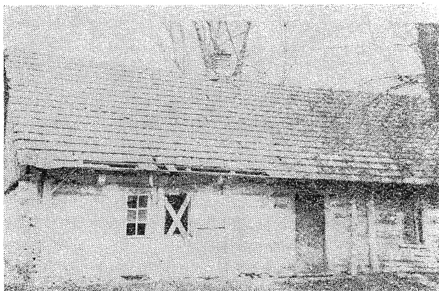
Najstarszy dom z datą 1813 opuszczony, grozi zawaleniem
