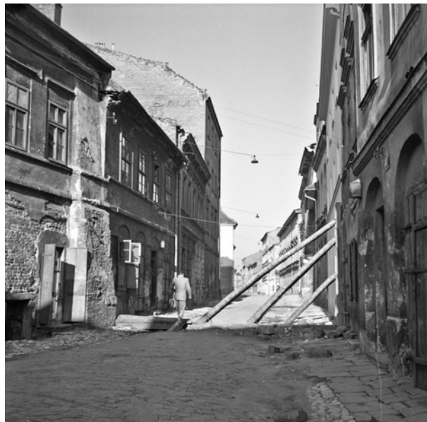
Fragment ul. Józefa z masywnymi belkami wspierającymi ścianę jednej z kamienic, pierwsza połowa lat sześćdziesiątych XX w.; w zbiorach MK, nr inw. MHK-9700/N/8
