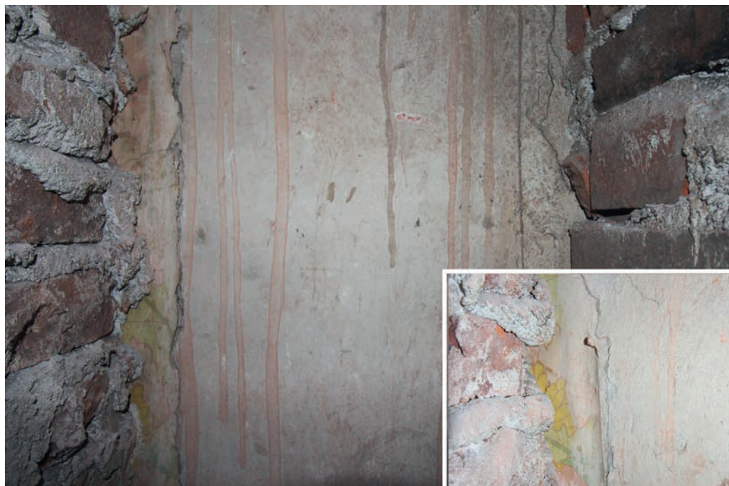
7. Wnętrze zamurowanej arkady piecowej. Po prawej stronie widoczny relikw secesyjnej tapety papierowej z charakterystycznym motywem florystycznym, obecnie przysłonięty zamurowaniem, 2020. Fot. Katarzyna Feć-Sfora.
