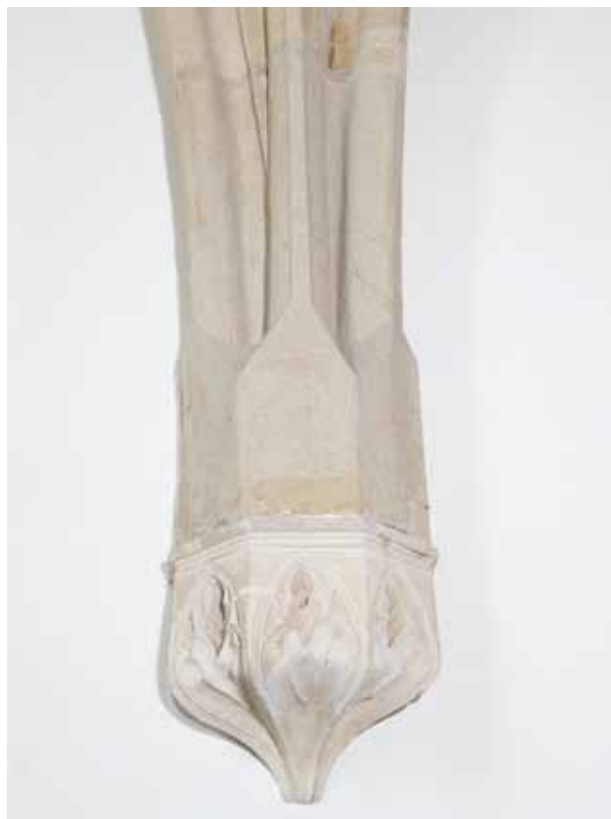
16. Kraków, klasztor Dominikanów, północna elewacja nawy północnej. Wspornik i nasada żeber sklepienia południowego traktu krużganka. Fot. Daniel Podosek
