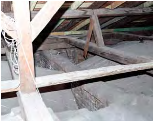
31. Kraków, kościół Dominikanów, strych nawy północnej. Korona muru pomiędzy kaplicami Małachowskich i Ligęzów z pozostałościami kamiennego gzymsu podokapowego kaplicy Ligęzów. Fot. Daniel Podosek
